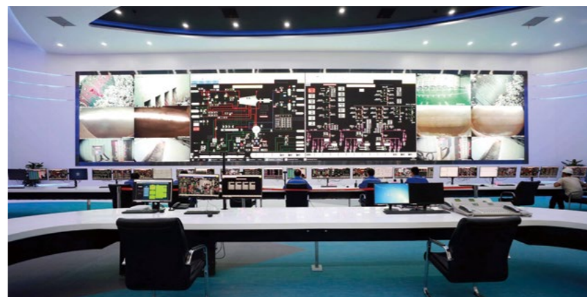
老港再生能源二期中控室
