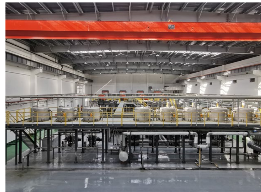
老港生物能源再利用中心是上海市规模最大的湿垃圾资源化处理设施
