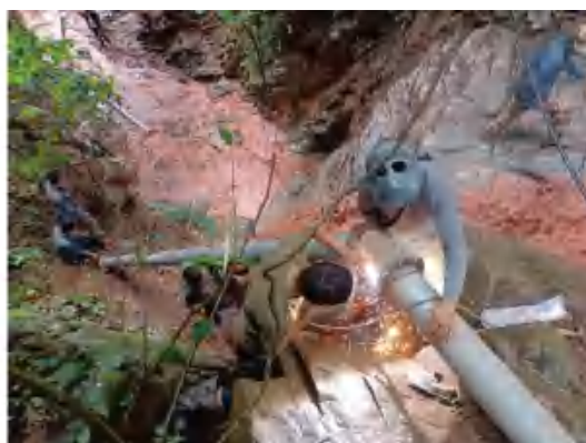
龙潭乡富厂村村组人饮、生产用水改造修复提升项目进行施工
