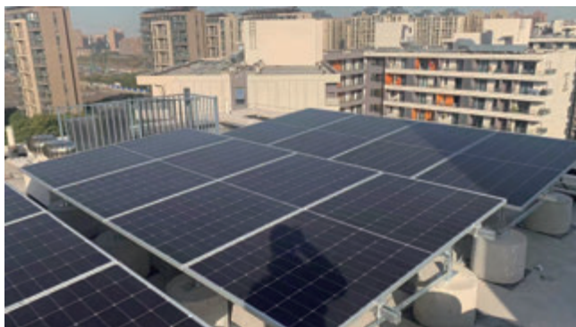
城投宽庭江湾社区屋顶光伏
