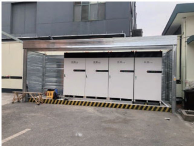
上海市奉贤区某储能电站项目
